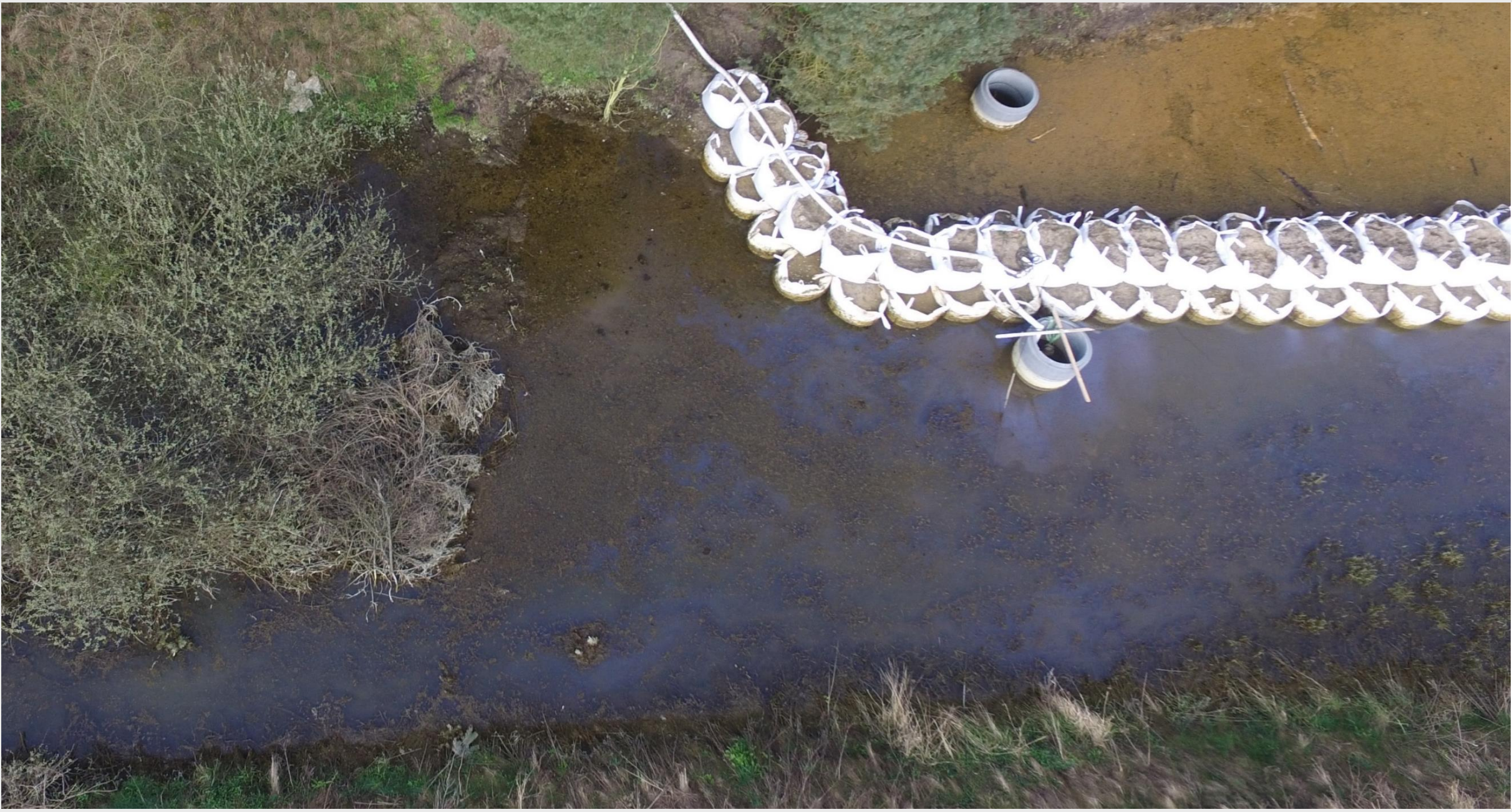
Sedimentationsbecken der Wasserhaltung
